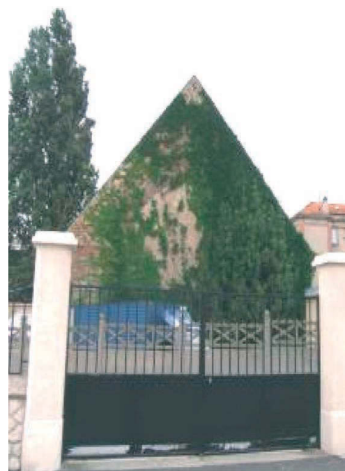
Vue de la façade arrière de l'église : façade pignon envahie de végétation volatile.
